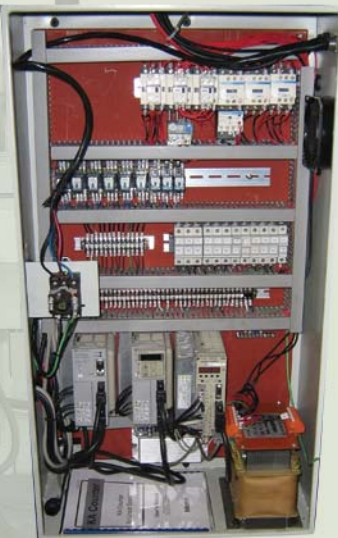
Panneau électrique selon les normes CSA Electric panel CSA approved
